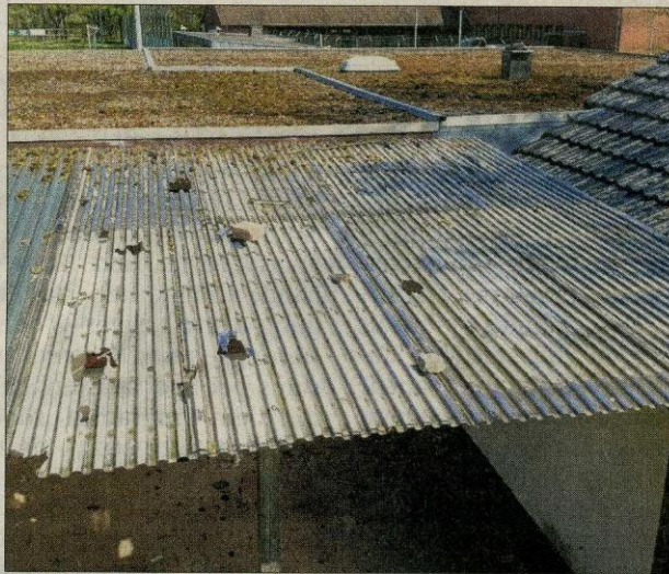
Das Dach des Schützenhauses an der Meerstraße wurde mutwillig zerstört. Foto: privat
