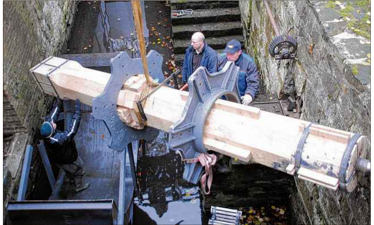
Die Welle des Wasserrades wurde mit einem Autokran über das Mühlengebäude an seinen neuen Standort befördert. Fotos: Ulrich Westermann
